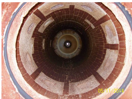
Komora spalania z kształtką palnikową
